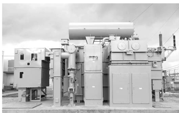
154 kV-100MVA菜種油入変圧器
